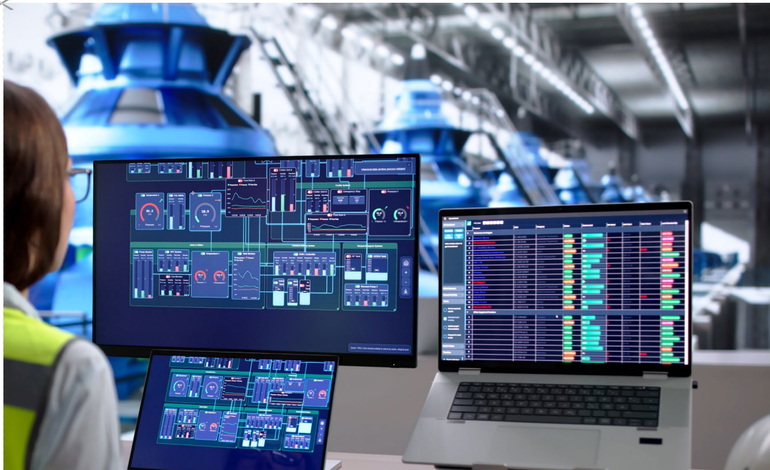
Mess- und Steuertechnik im Wasserwerk bzw. in der Wasserversorgungsanlage
